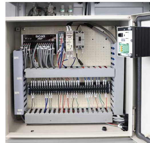
架台内の制御盤にはSiOが取り付けられており、MKグリップにエアーを送るバルブ開閉など周辺機器の制御に使われている。
